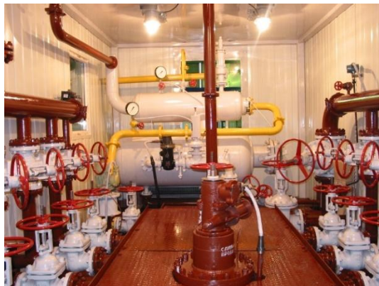
Рисунок 2.4 – Автоматична групова замірна установка
