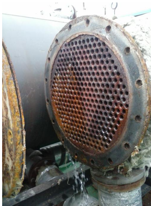
Рисунок 4.4 – Кожухотрубний теплообмінник з корозією трубок
