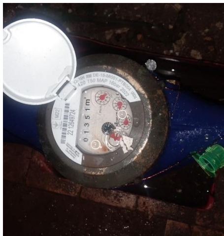
Рисунок 1.5 – Лічильник обліку холодної води
