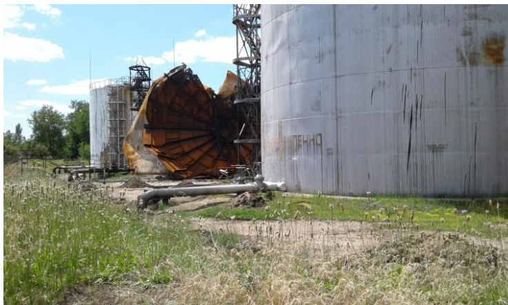
Рисунок 1.6 – Зруйновані резервуари з нафтою [9]
