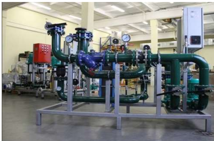
Рисунок 3.1 – Індивідуальний тепловий пункт
