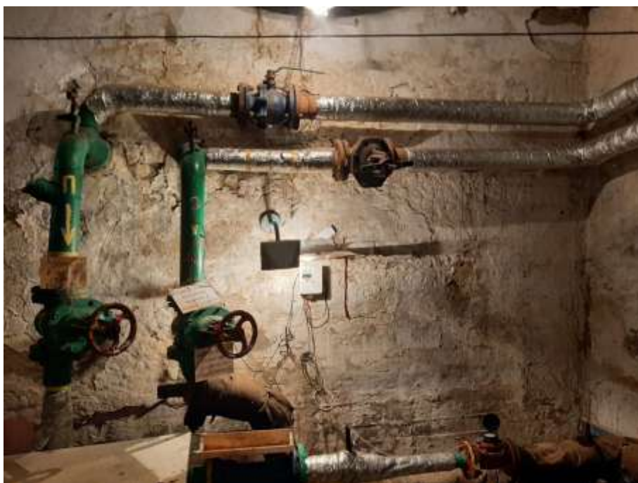
Рисунок 1.2 – Тепловий пункт гуртожитку
