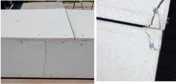
Рис. 2 – Тріщини та деформації облицювання з магnezитових плит
