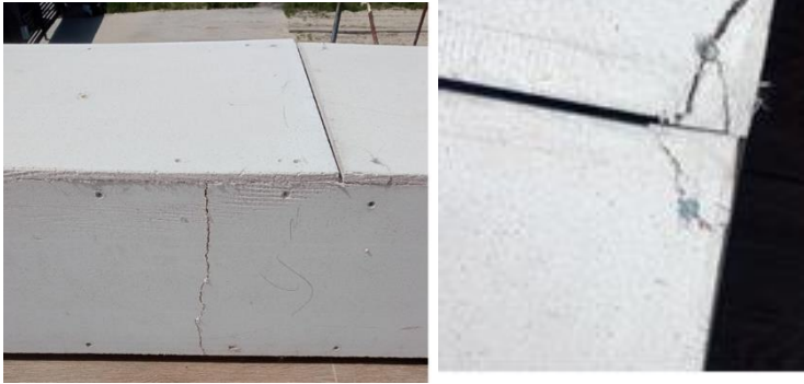
Рис. 2 – Тріщини та деформації облицювання з магnezитових плит
