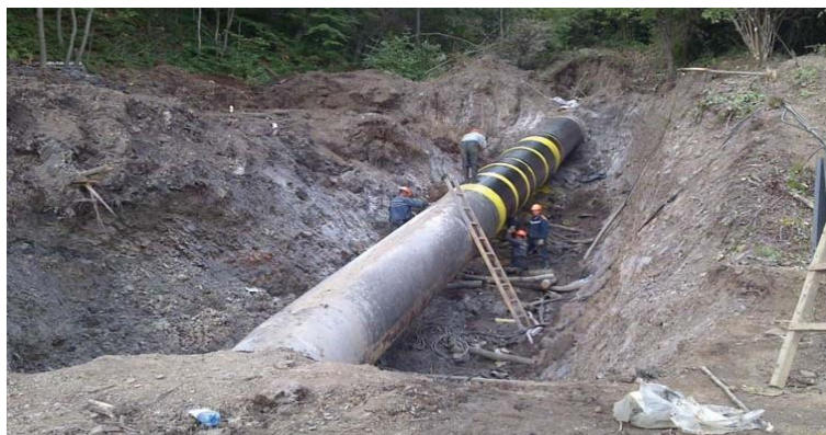
Рисунок 1.3– Аварія газопроводу у пухкому ґрунті
