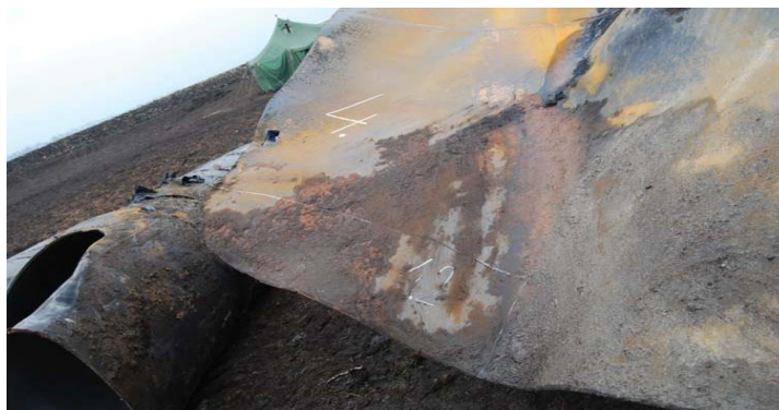
Рисунок 1.4 – Аварія газопроводу у твердому ґрунті
