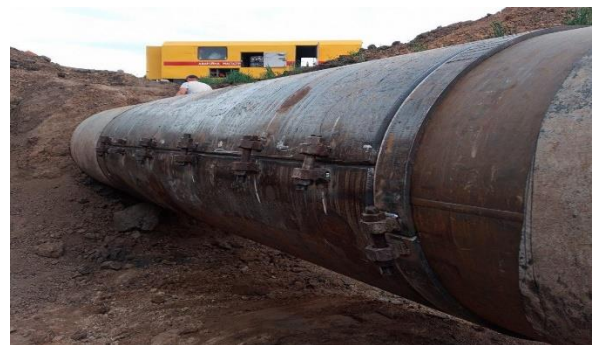
Схема змонтованої на трубопровід муфти КТР5 герметичної з розрізними кільцями на трубопроводі «Слець-Кременчук-Кривий Ріг»
