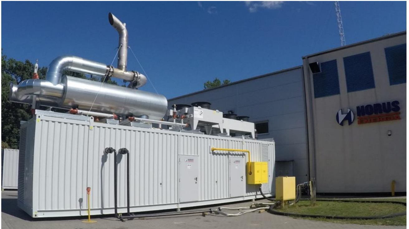
Рисунок 3.1 Газопоршнева когенераційна установка «Elteco»
