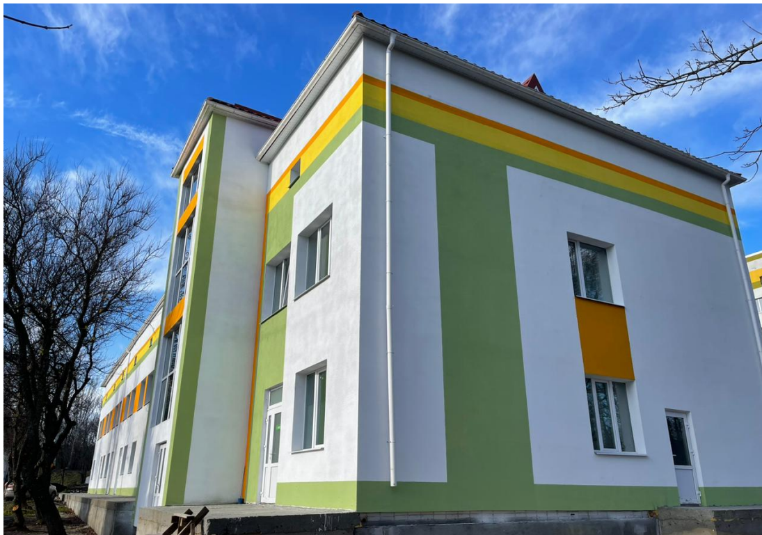
Рис. 3.11 — Архітектурний вигляд інфекційного відділення Тростянецької міської лікарні з бічної перспективи в процесі відновлення та термомодернізації (DREAM, 2022)
