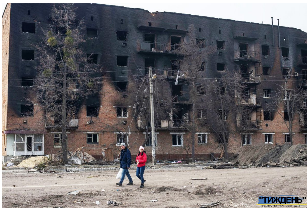
Рис. 2.4 — Стан зруйнованого багатоповерхового житлового будинку по вул. Благовіщенській, 53 у м. Тростянець після окупації
