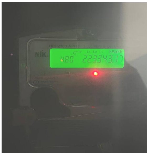
Рисунок 1.6 – Лічильник електричної енергії
