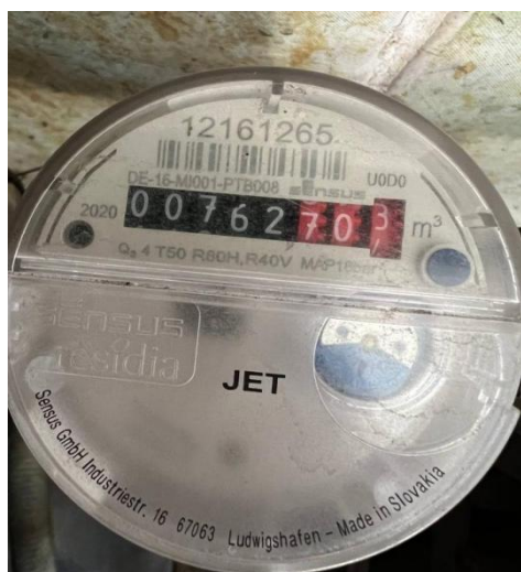
Рисунок 1.7 – Лічильник обліку холодної води
