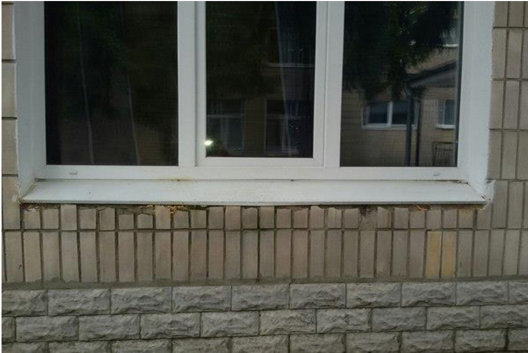
Рисунок 1.2 – Неякісно встановлені віконні відливи
