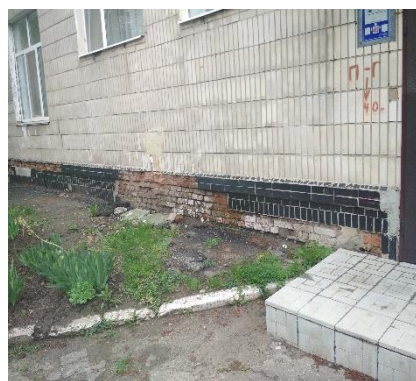
Рисунок 1.7 – Обсипання фасадної плитки з фундаменту
