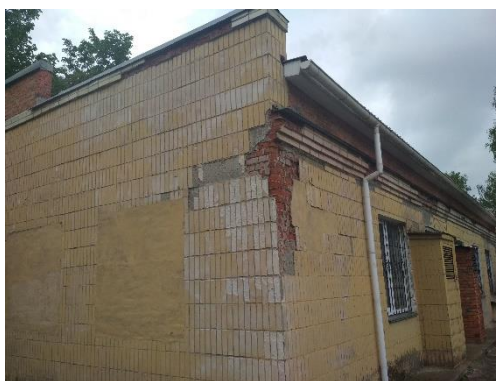
Рисунок 1.6 – Обсипання фасадної плитки зі стін
