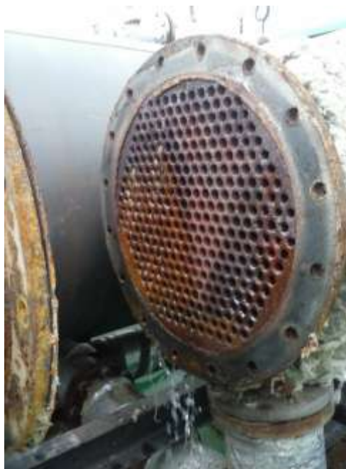
Рисунок 4.3 – Кожухотрубний теплообмінник з корозією трубок
