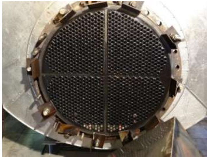
Рисунок 4.2 – Кожухотрубний теплообмінник з вирваними трубками
