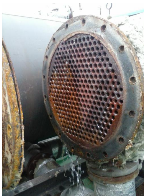
Рисунок 4.3 – Кожухотрубний теплообмінник з корозією трубок
