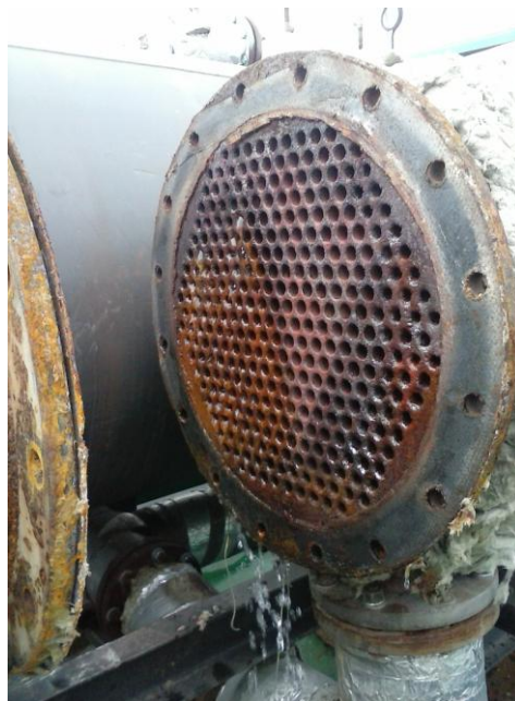
Рисунок 4.3 – Кожухотрубний теплообмінник з корозією трубок
