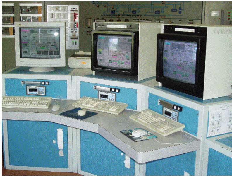
Рисунок 2.5 - Станція контролю і управління MOIS
