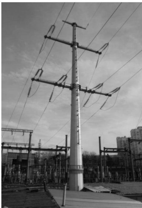
Рисунок 1.7 – Анкерна багатогранна металева опора ПЛ 110 кВ
