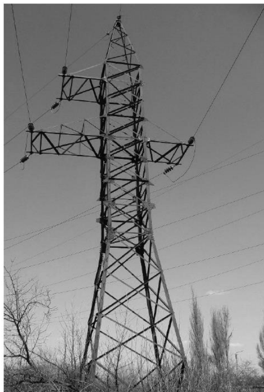
Рисунок 1.6– Металева анкерна кутова опора ПЛ 35 кВ
