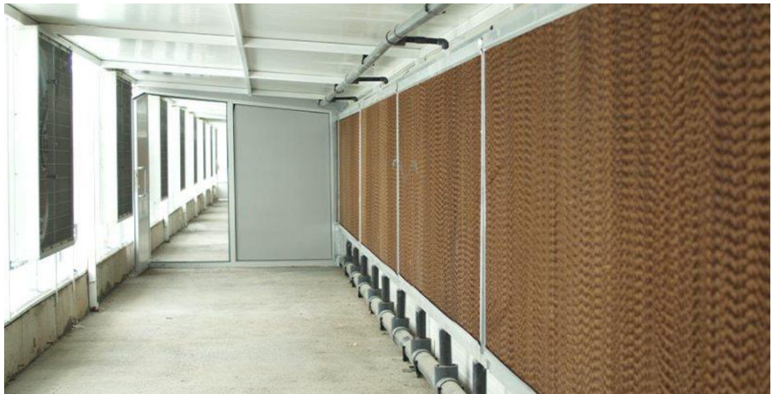
Рисунок 8 - Охолодження приміщень теплиць
