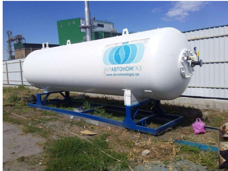
Рисунок 4.5 – Резервуар для зберігання стисненого рідкого вуглецевого газу
