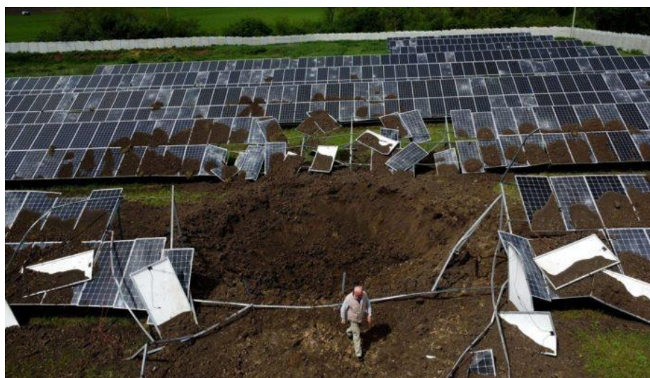
Рисунок 2.4 – Постраждала від ракетного обстрілу сонячна електростанція компанії Solar Generation у Харківській області – ФЕС "Мерефа" (фото Станіслава Ігнат'єва)
